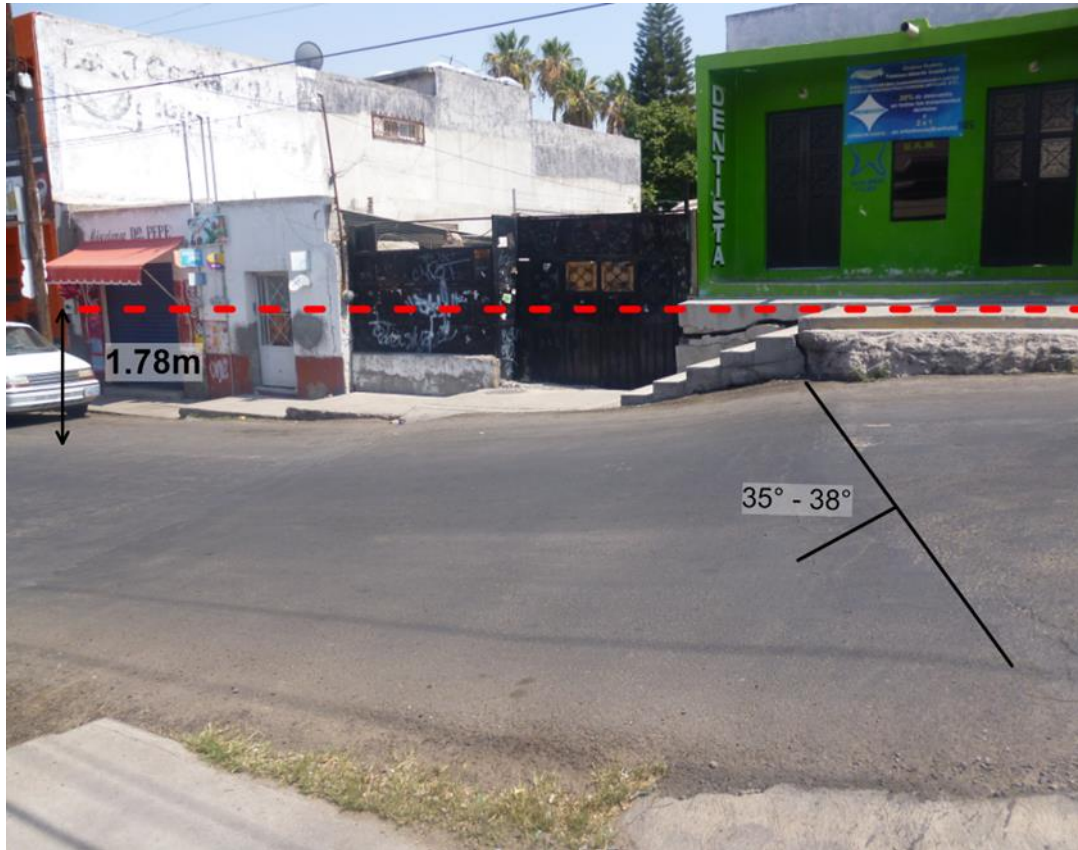
Figura 4 1 Falla normal con desplazamiento vertical 1.78m, en Celaya, Gto., México.
