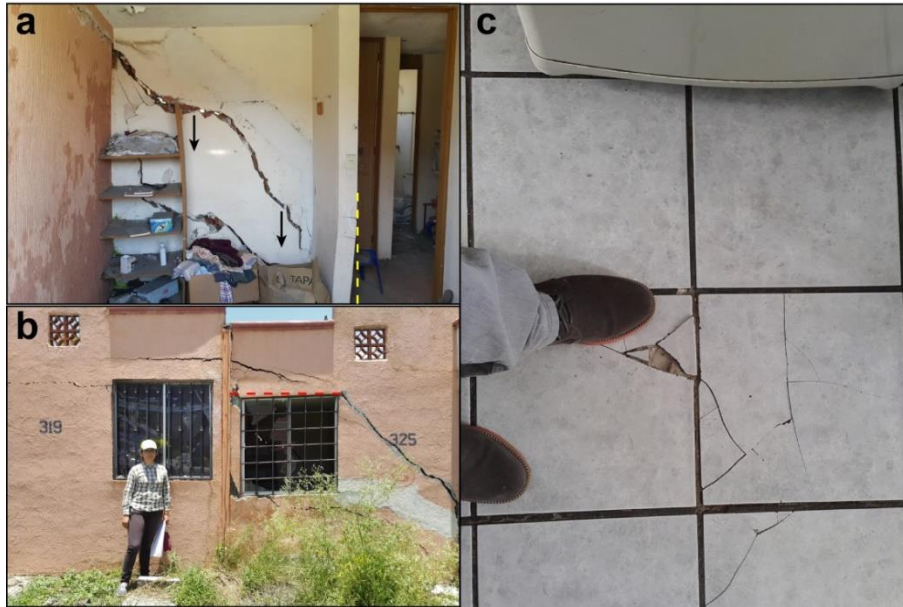
Fig. 5.9. Daños en casas-habitación del fraccionamiento Puerta del Sol. Se identifican grietas de tensión a 45° sobre muros de carga (a y b), deformación de marcos de ventana (b) y fracturamiento de piso (c) por efectos del hundimiento diferencial.
