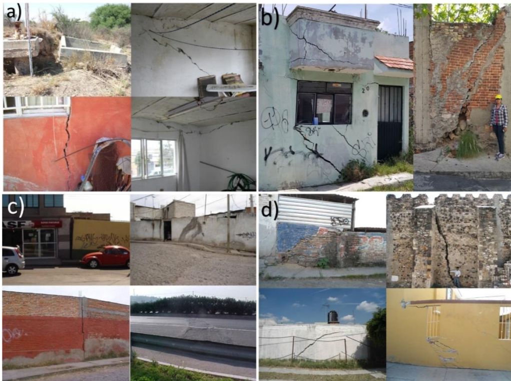
Fig. 3.14. Efectos de la SDCE en las estructuras civiles, a) Aguascalientes: daños en muros de carga y techos, resurgimiento y rotura de encamisado de pozos; b) Morelia: abandono de viviendas; c) Querétaro: separación de elementos estructurales y fisuras de suelo en carretera; y d) San Luis Potosí: grietas diagonales y distorsión en marcos de ventanas. Las fotos en a) y c) son tomadas de Pacheco-Martínez et al. (2013) y Pacheco-Martínez (2010), respectivamente.
