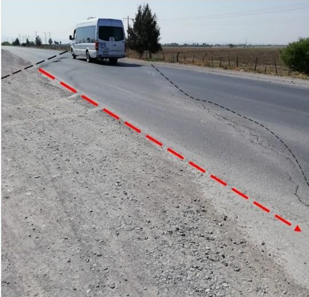
Figura 48. Evidencia fotográfica de la deformación del pavimento por la falla Buena Vista 1.
