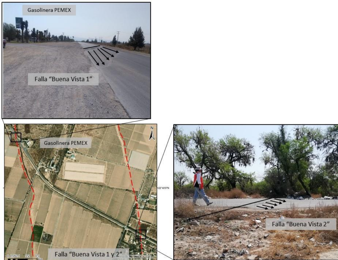
Figura 47. Evidencia de la deformación del pavimento en la Carretera Moctezuma – San Lorenzo, de las fallas de Buena Vista 1 y 2.
