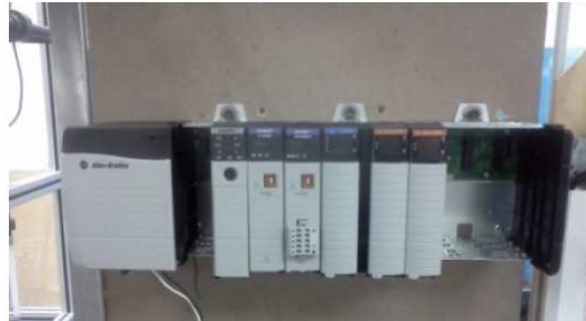
Figura 2.7: PLC Allen Bradley Utilizado para dar las secuencias de control al servo-drive
