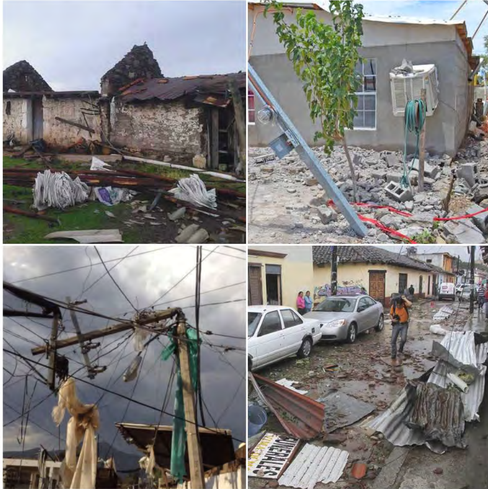
Figura 2.7 Tipos de daños ocasionados. Huimiyucan (2014), Ojinaga (2013), Tangancicuaro (2013) y San Cristóbal de las Casas (2014). Elaboración propia con múltiples fuentes 14 .
