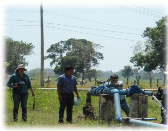
Fotografía 2.2A. Toma de agua subterránea proveniente de un pozo.
