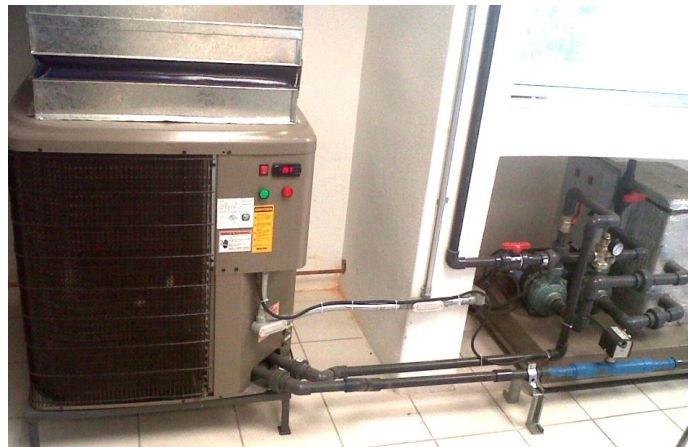
Figura 2.3: Sistema de refrigeración.
