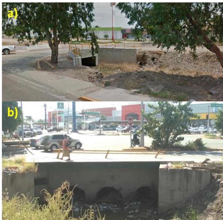
Figura 34. Ejemplos de tipos de alcantarilla en la zona de estudio. Alcantarilla de caja (a: recuperado de Street View; agosto 2015) y alcantarilla de tubería triple (b; López, 2018) en el Dren Álamo, Los Mochis.
