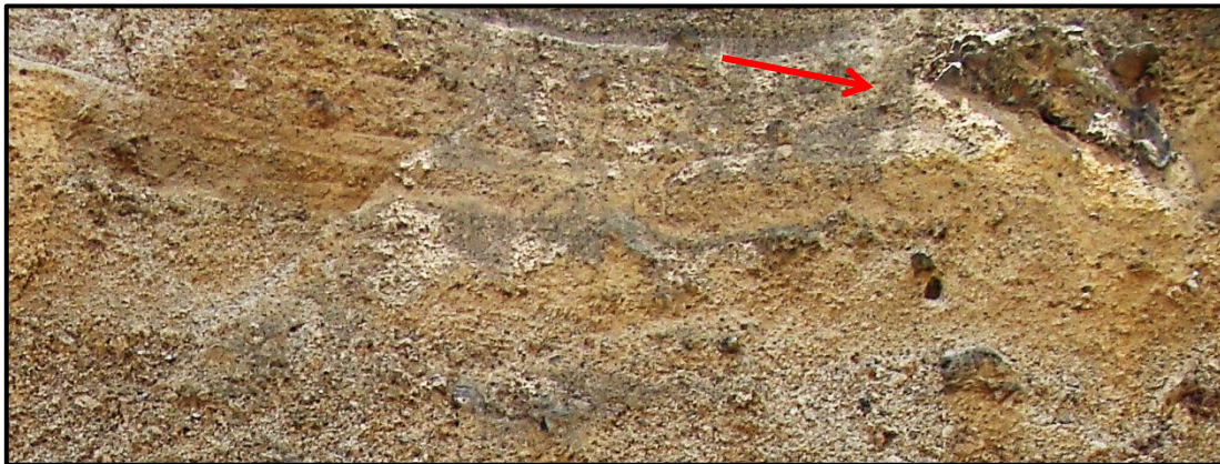
Figura 3.10.- Cima de la sección tipo donde se pueden apreciar el impacto de balísticos
